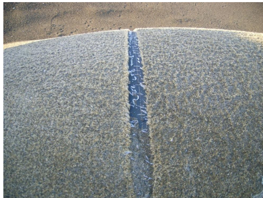
過剰なポンプ内圧による破損
