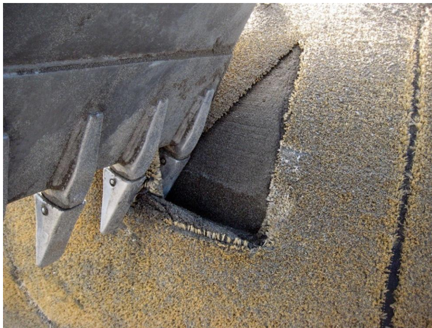
重機接触による破損
